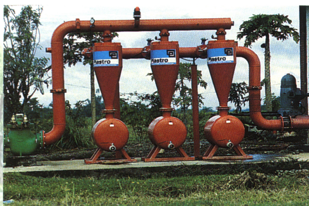
รูปที่ 26 กรองแยกทราย
